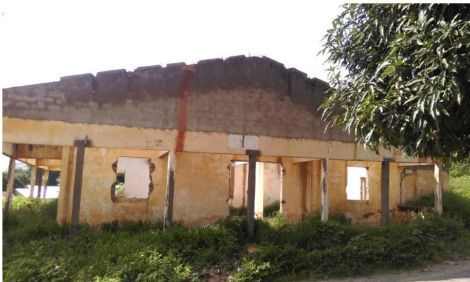
Infrastructure détruite lors des conflits dans le quartier Mamadou-Sara (Photo : Thierry Vircoulon, Bouar, 31 juillet 2017)
